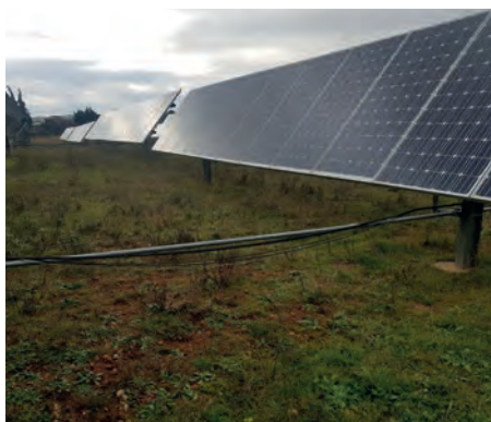
Photo 25 : Des barres de commande trop basses dans un parc photovoltaïque trackers 1 axe d'ancienne génération (©Idele)
