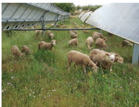
Photo 19 : Les barres de commandes de trackers 1 axe ne posent pas de problèmes si les animaux peuvent circuler de façon fluide au-dessous, comme dans la centrale du Canadel (83) (© VoItalia)
