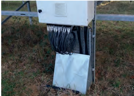
Photos 64 : Présence de câble à 50cm de haut, risque d'endommagement de la structure sans protection (© Idele)
