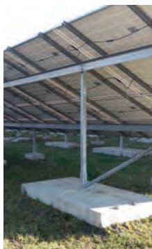
Photo 30 : Table fixe bi-pieux sur dalle de béton (© Idele)
