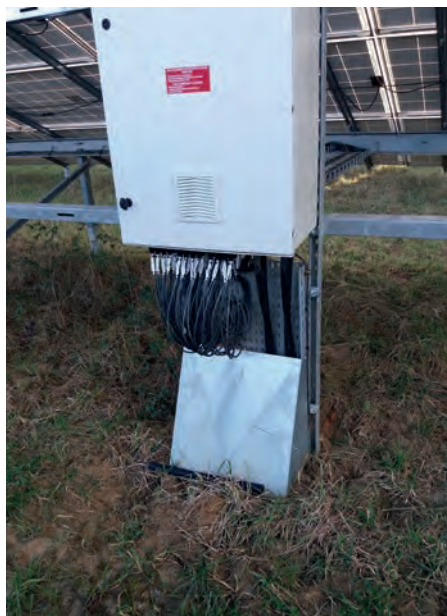
Photo 33 : Câblages électriques laissés apparents à faible hauteur pouvant être rongés par les animaux (© Idele)
