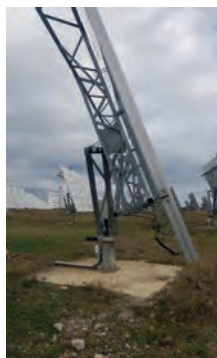
Photo 31 : Double-tracker mono-pieu sur dalle de béton (© Idele)
