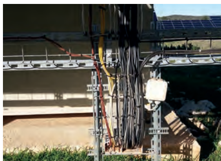
Photo 36 : Câblages laissés apparents (©Idele)
