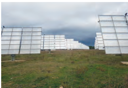
Photo 16 : Panneaux photovoltaïques trackers 2 axes à Grabels (34) (© Idele, parc géré par Neoen)
