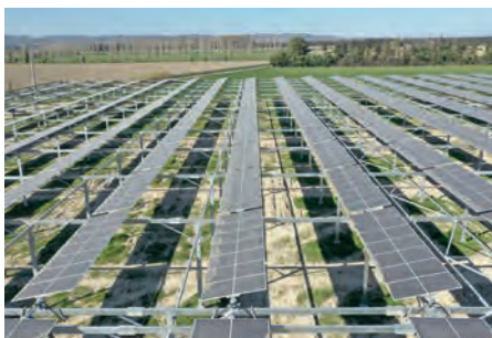
Photo 17 : Ombrières photovoltaïques au Cabanon (© Voltalia)
