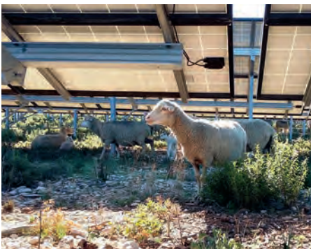
Photo 8 : Centrale photovoltaïque du Castellet (© Voltalia)
