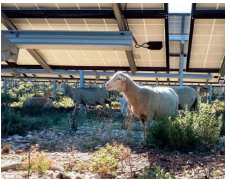
Photo 8 : Centrale photovoltaïque du Castellet (© Voltalia)
