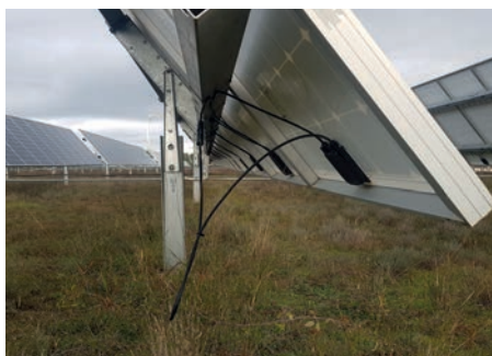
Photos 34 et 35 : Les câbles électriques ont tendance à pendre à faible hauteur, à l'arrière des panneaux, engendrant un risque d'étranglement, en particulier chez les jeunes animaux. (©Idele)
