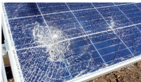
Photo 26 : Panneau photovoltaïque endommagé (© Andrei Merkulov/AdobeStock)
