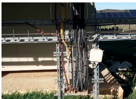
Photo 36 : Câblages laissés apparents (©Idele)
