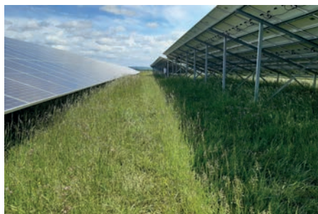
Photo 62 : Centrale de Bioule (© Idele, centrale gérée par Neoen)
