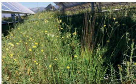
Photo 13 : Centrale photovoltaïque du Castellet (83) (© Voltalia)
