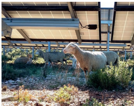
Photo 8 : Centrale photovoltaïque du Castellet (© Voltalia)
