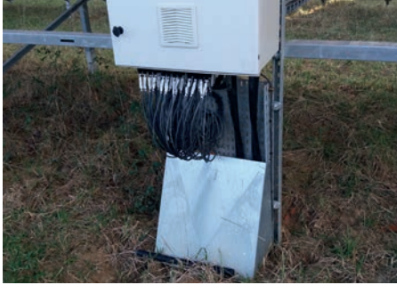
Photos 64 : Présence de câble à 50cm de haut, risque d'endommagement de la structure sans protection (© Idele)
