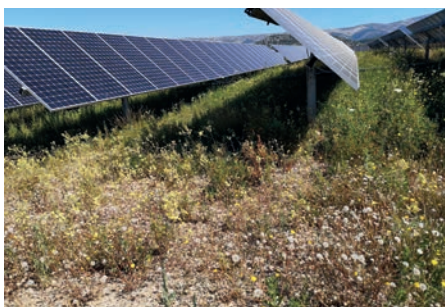
Photo 15 : Parc photovoltaïque à panneaux trackers 1 axe au Castellet (83) (© Voltalia)
