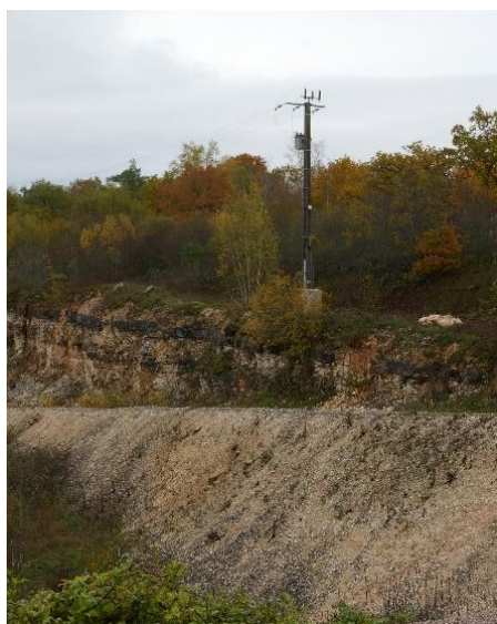
Transformateur de poteau en place avec son armoire de distribution
