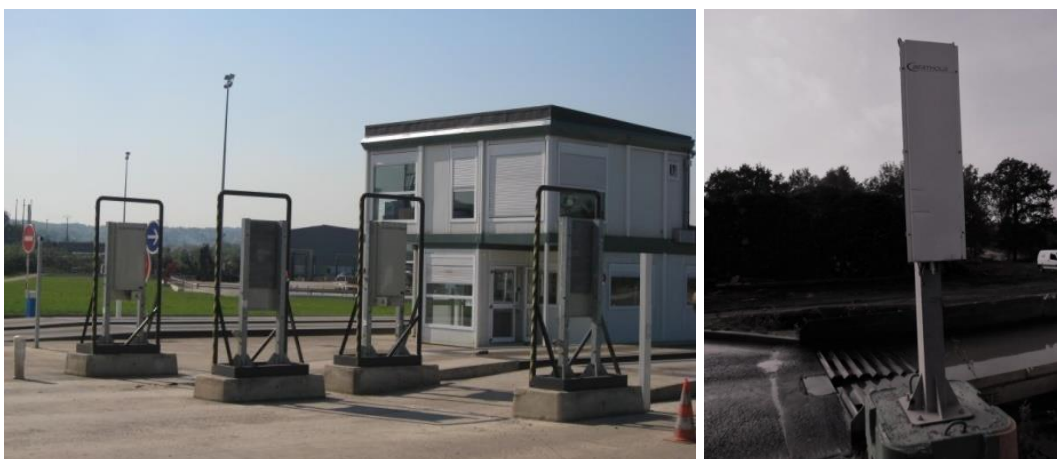
Illustration n° 6 : Exemples de portique de détection de non-radioactivité
