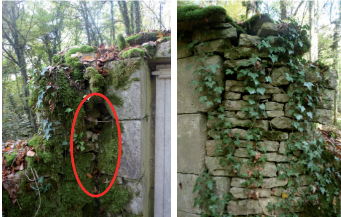
Fig VII.B.1.9 : vue sur les dégâts de l'entrée 9
