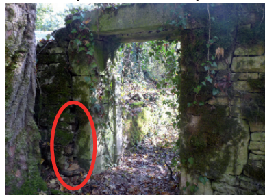
Fig VII.B.1.10 : vue sur les dégâts de l'entrée 10
