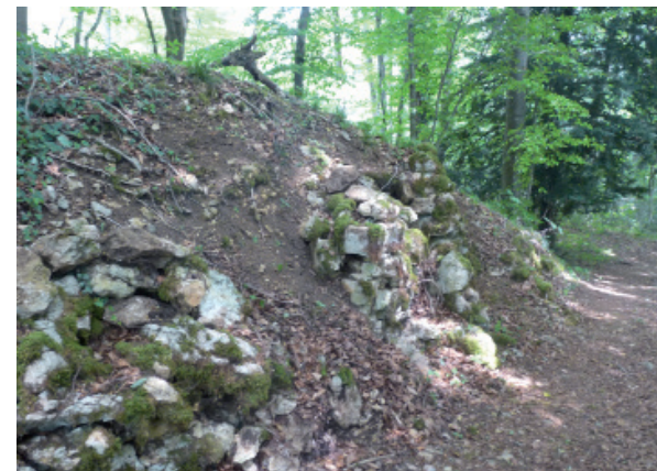
Fig III.B.2 : vue d'un mur effondré
