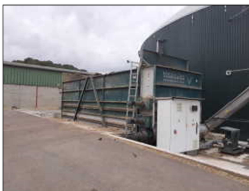
Trémie d'incorporation devant le digesteur
