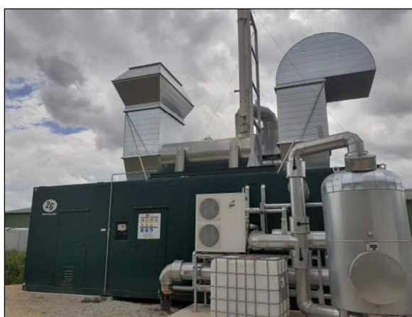
Moteur de cogénération 2G – 499-516 kWé
