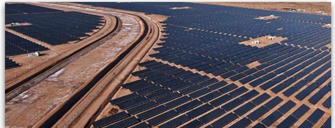
Centrale photovoltaïque au sol de Kamuthi, Inde
